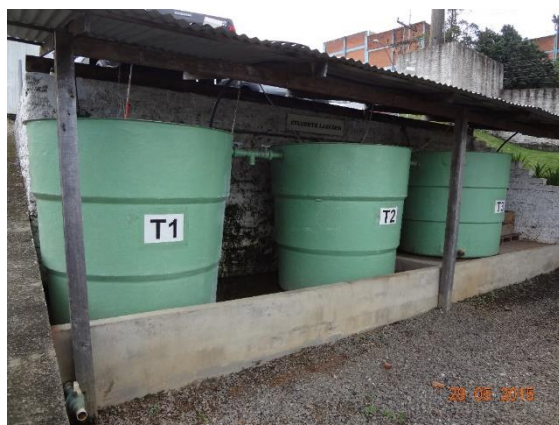
Figura 6 – Reservatório efluente tratado
