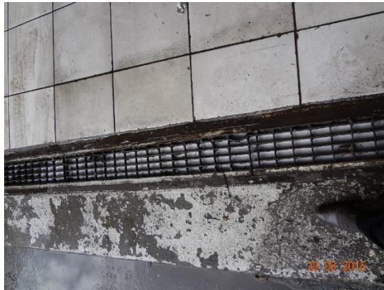
Figura 3 – Canaleta box lavagem
