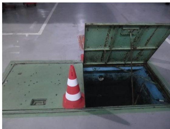
Figura 2 – Caixa de Acúmulo
