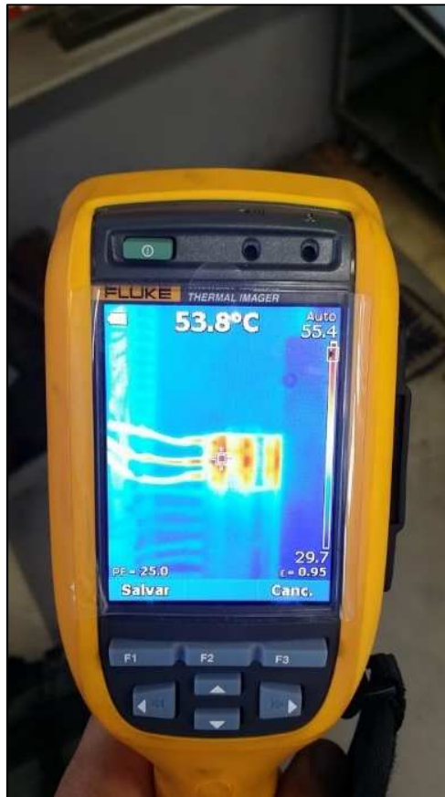
Figura 7 - Disjuntor do quadro de ar-condicionado que estava superaquecendo.
