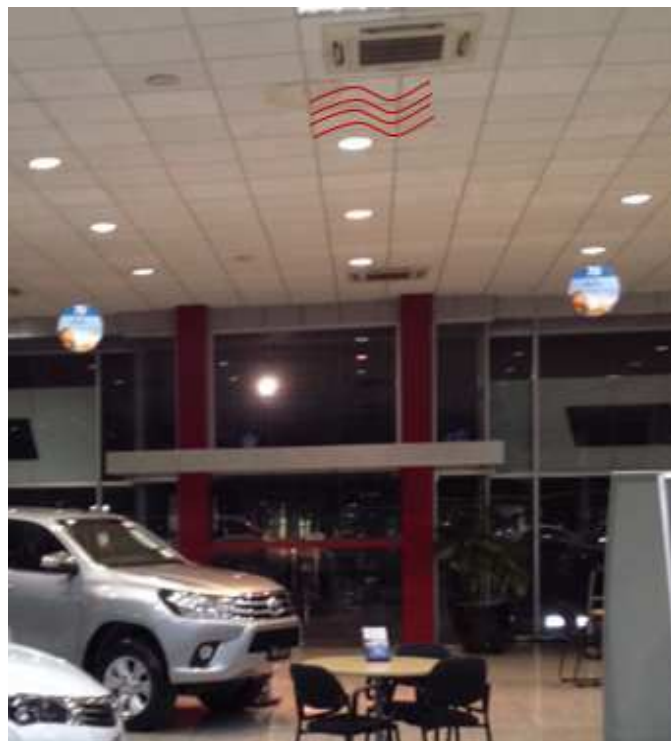
Figura 177 – Situação anterior em que ocorria interferência da iluminação no consumo de energia do sistema de climatização por irradiação de calor. Economia não mensurada.
