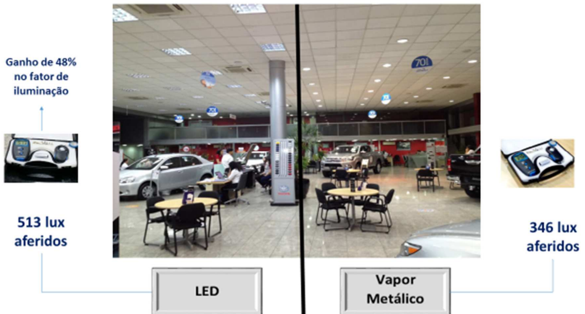
Figura 2524 – Antes e Depois da instalação de iluminação em LED no Showroom
