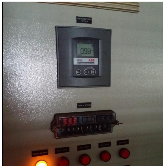
Figura 12 - Medidor de fator de potência marcando 0,98 indutivo (valor adequado).
